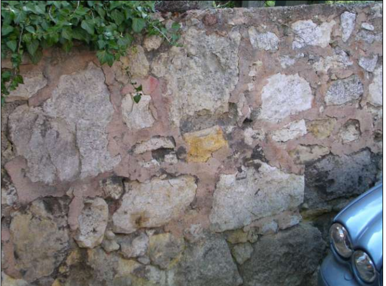
Bild 10: Westmauer (außen): alte Ausbesserungen
