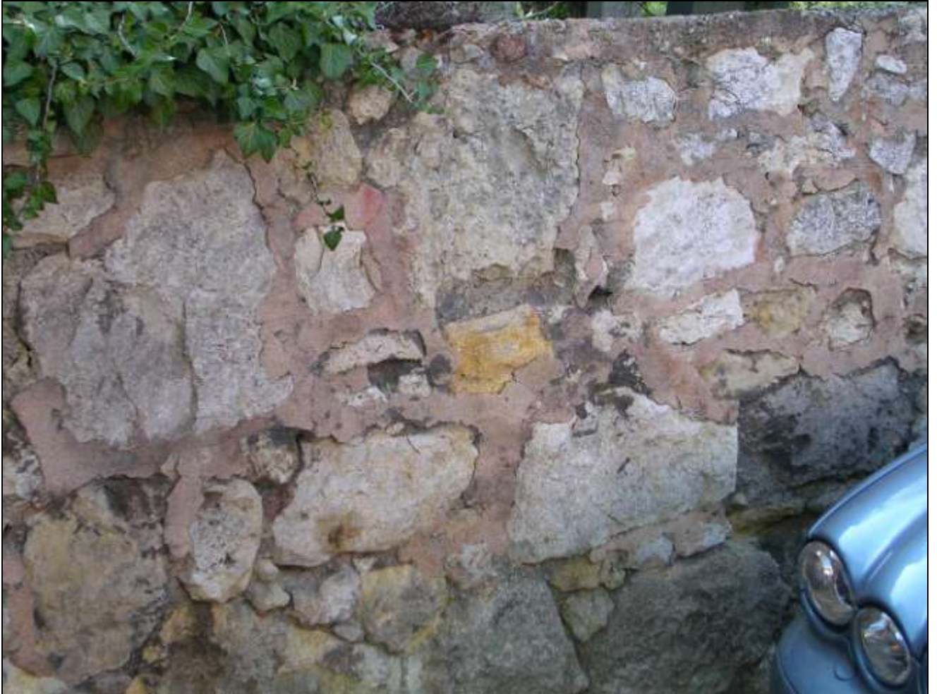
Bild 10: Westmauer (außen): alte Ausbesserungen
