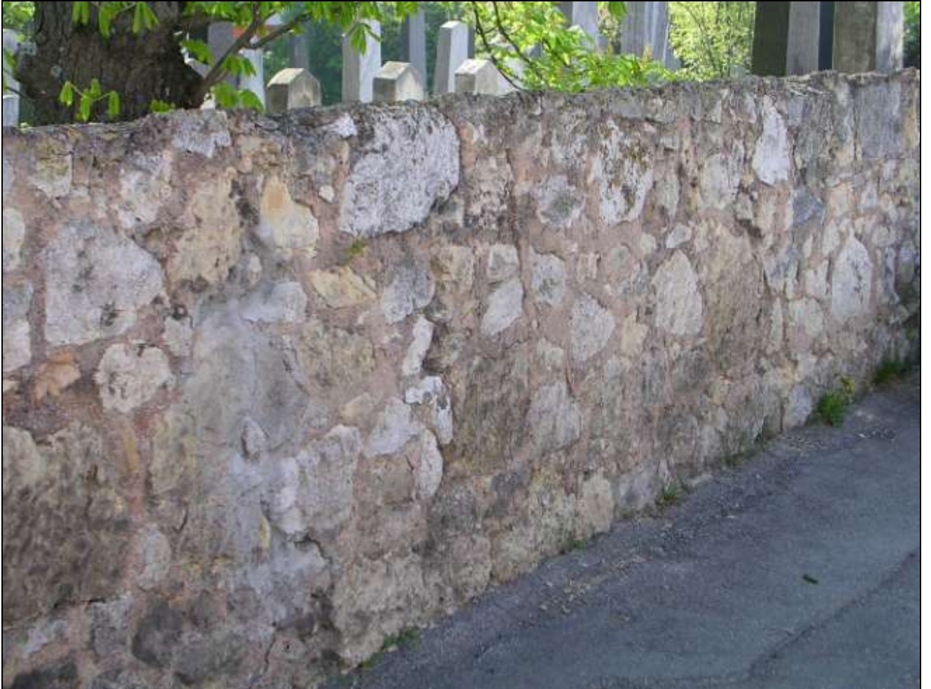
Bild 11: Westmauer (außen) alte und sehr alte Sanierungen
