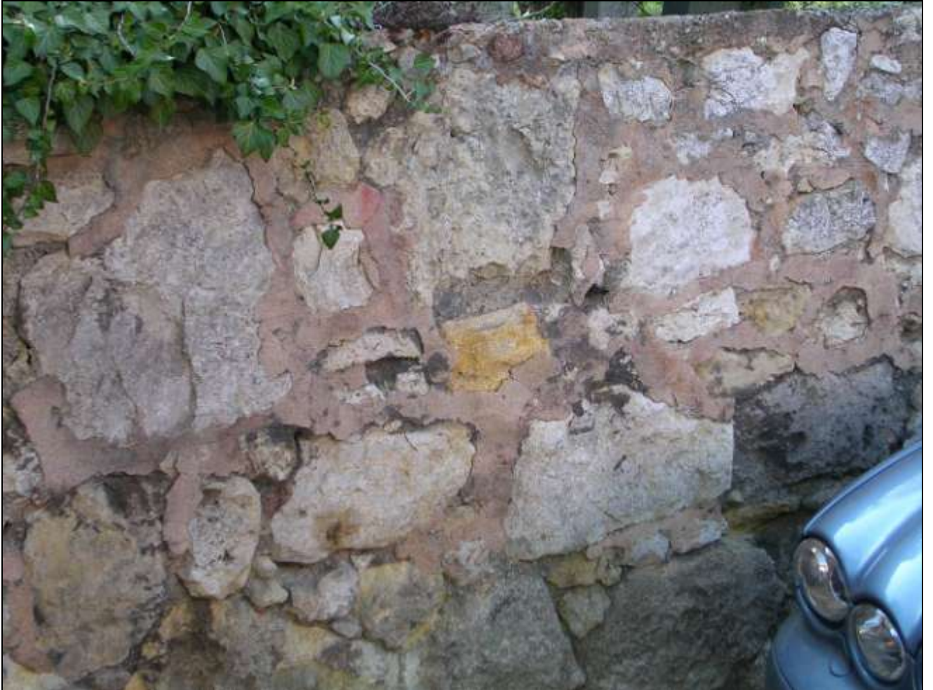
Bild 10: Westmauer (außen): alte Ausbesserungen
