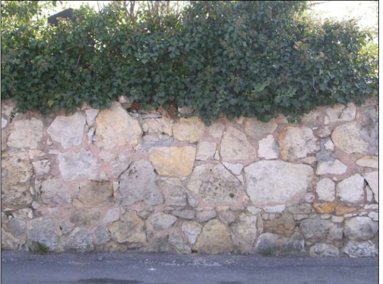
Bild 12: Westmauer (außen) Bsp. für Schaden (Loch)
