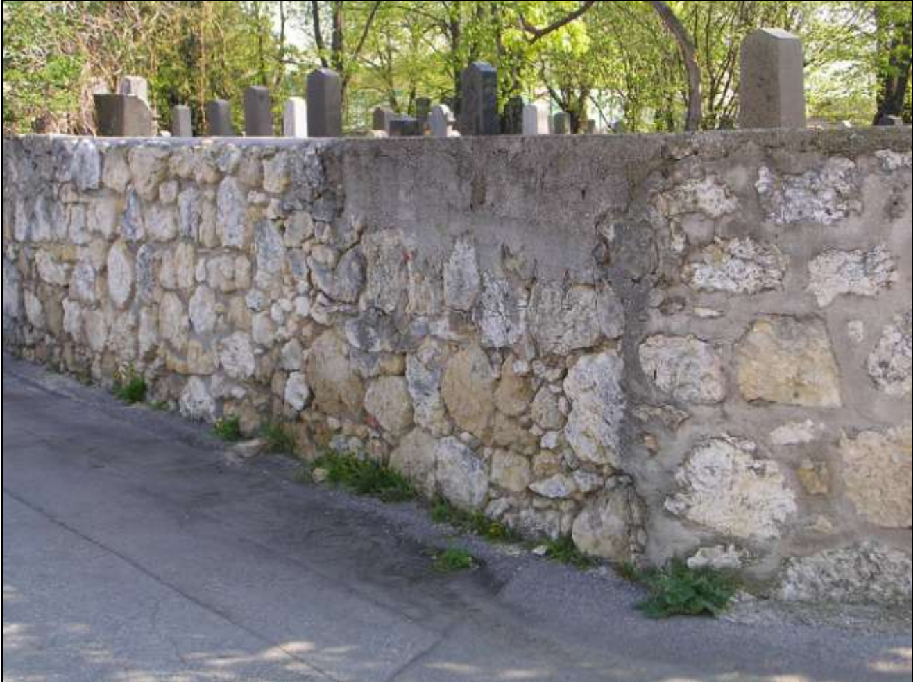
Bild 13: Westmauer (außen) Bsp. sanierungsbedürftigen Abschnitt (mittig, links) und sanierter SW-Ecke (rechts)
