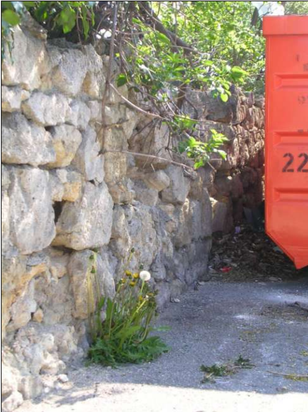
Bild 15: Südmauer (außen) Bsp. für massiven Schaden (Ausbrüche und Loch)
