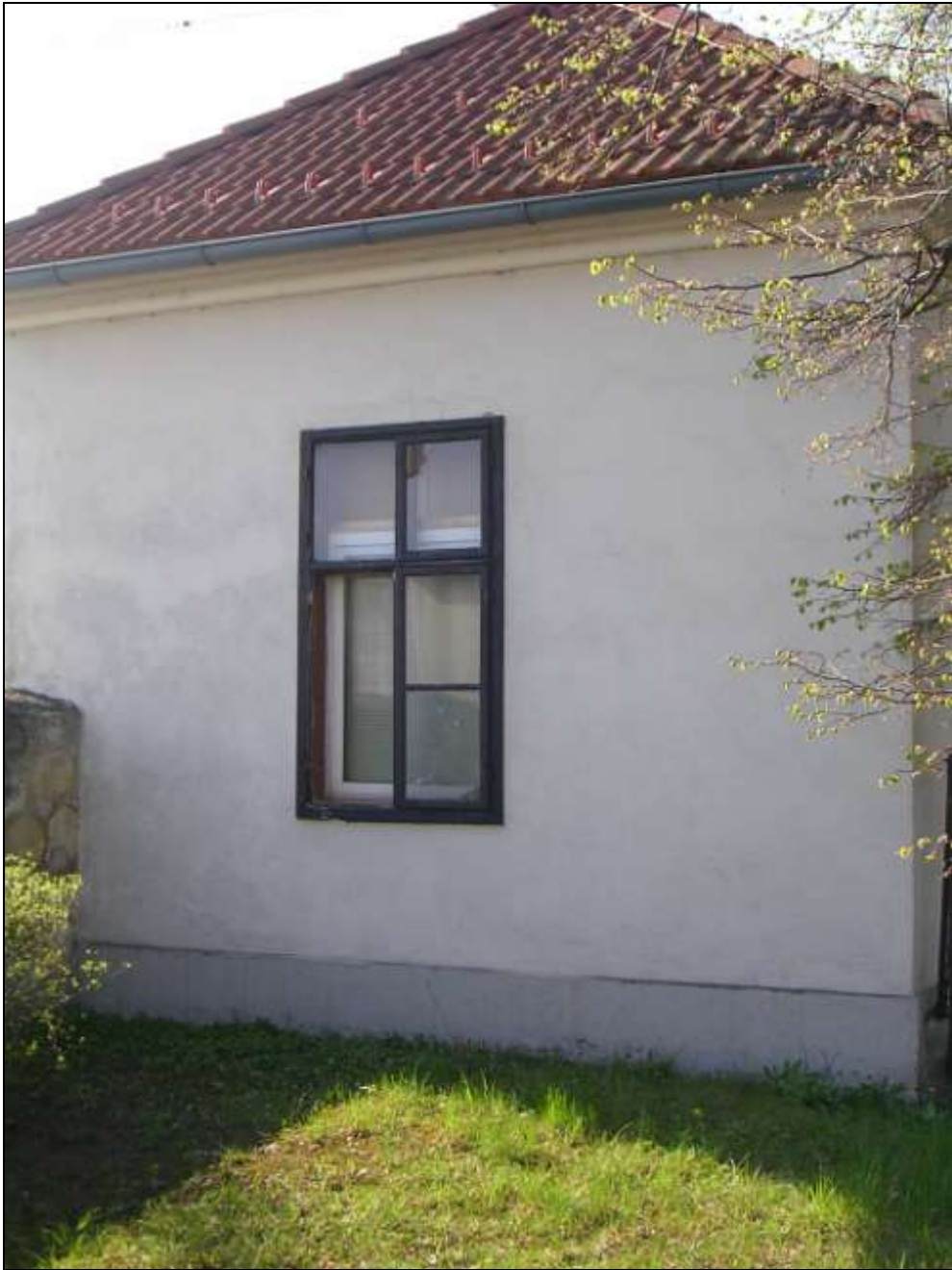
Bild 23: Gebäude (Nordseite „Leichenhaus“) Kaputtes Fenster
