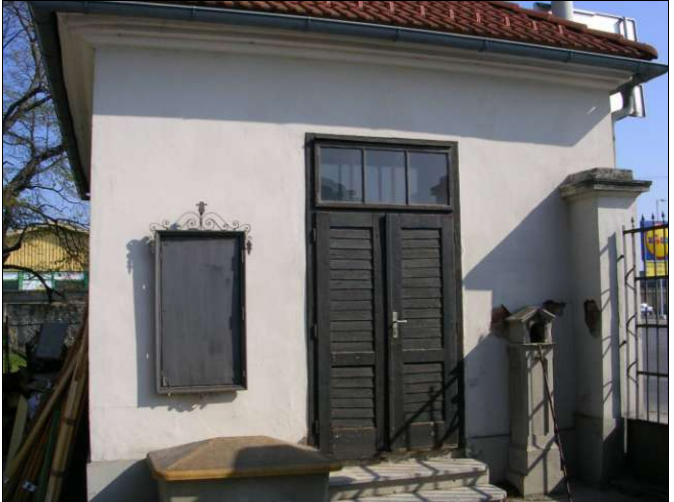
Bild 22: Gebäude (Südseite „Leichenhaus“) Ausbrüche (rechts) wegen Nässe- bzw. Feuchtigkeitsschäden
