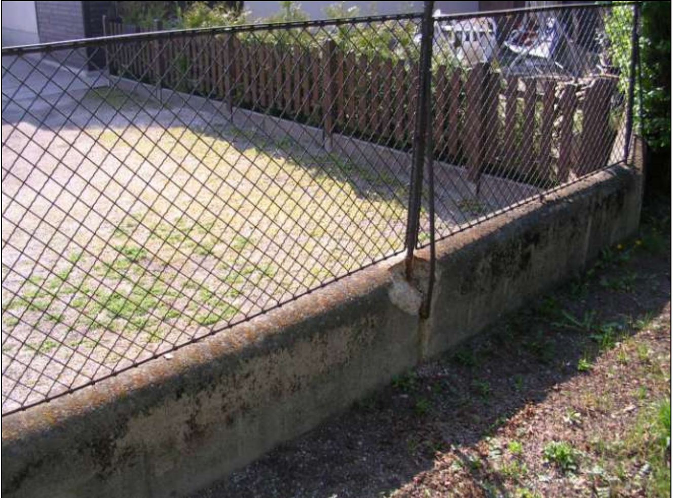
Bild 25: Mauersockel mehrere Ausbrüche im Beton, beschädigte Zaunfelder
