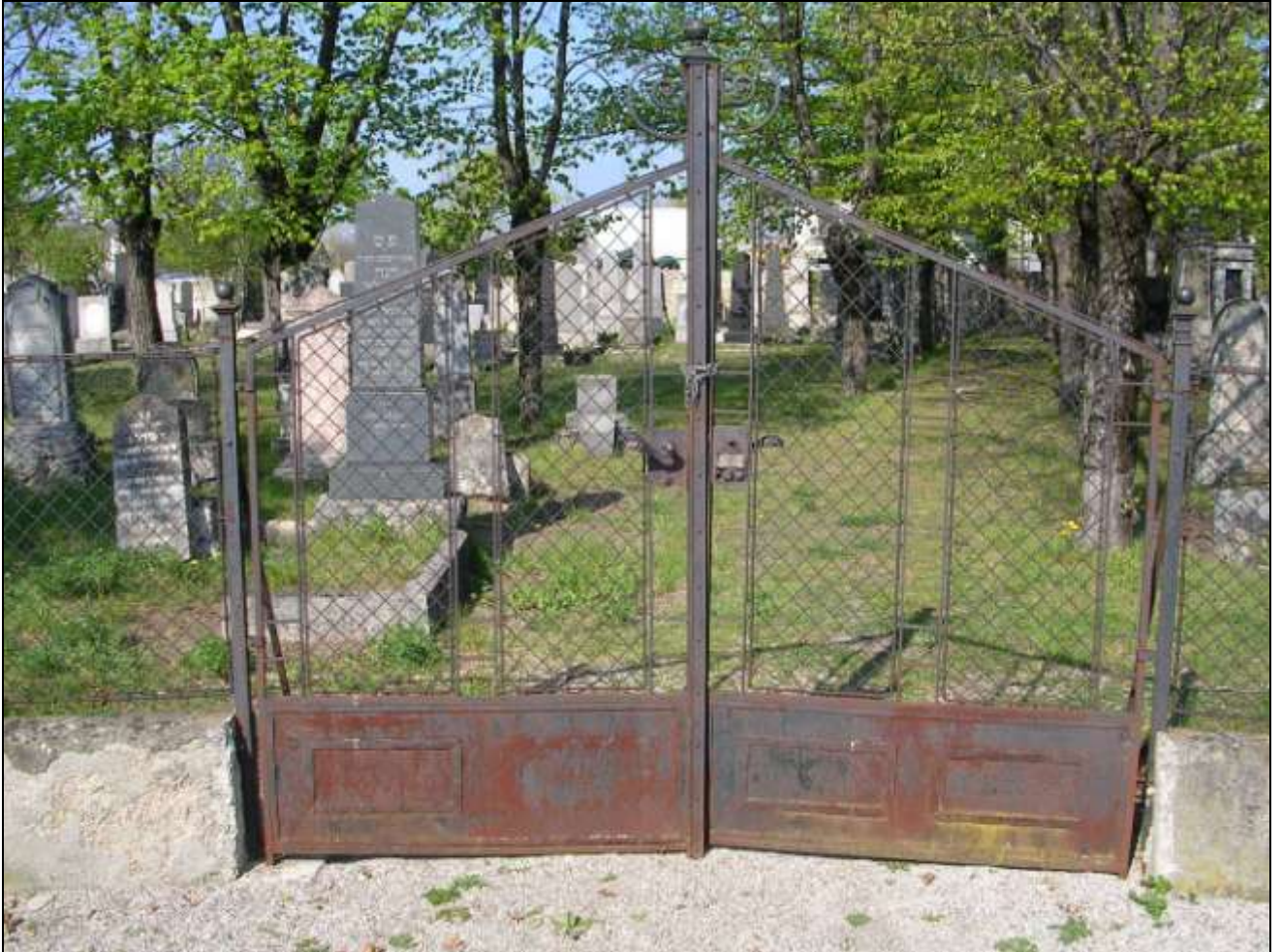
Bild 24: Zugangstor (innen) Rostschäden, kein funktionstüchtiger Schließ-/Sperrmechanismus
