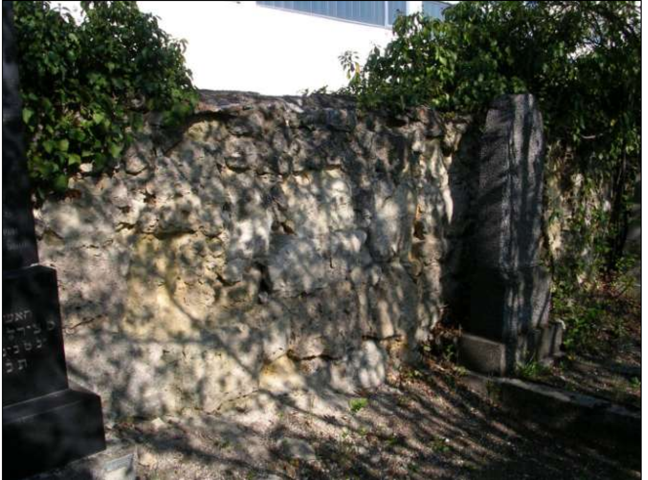
Bild 18: Westmauer (innen) Auswaschungen und Ausbrüche
