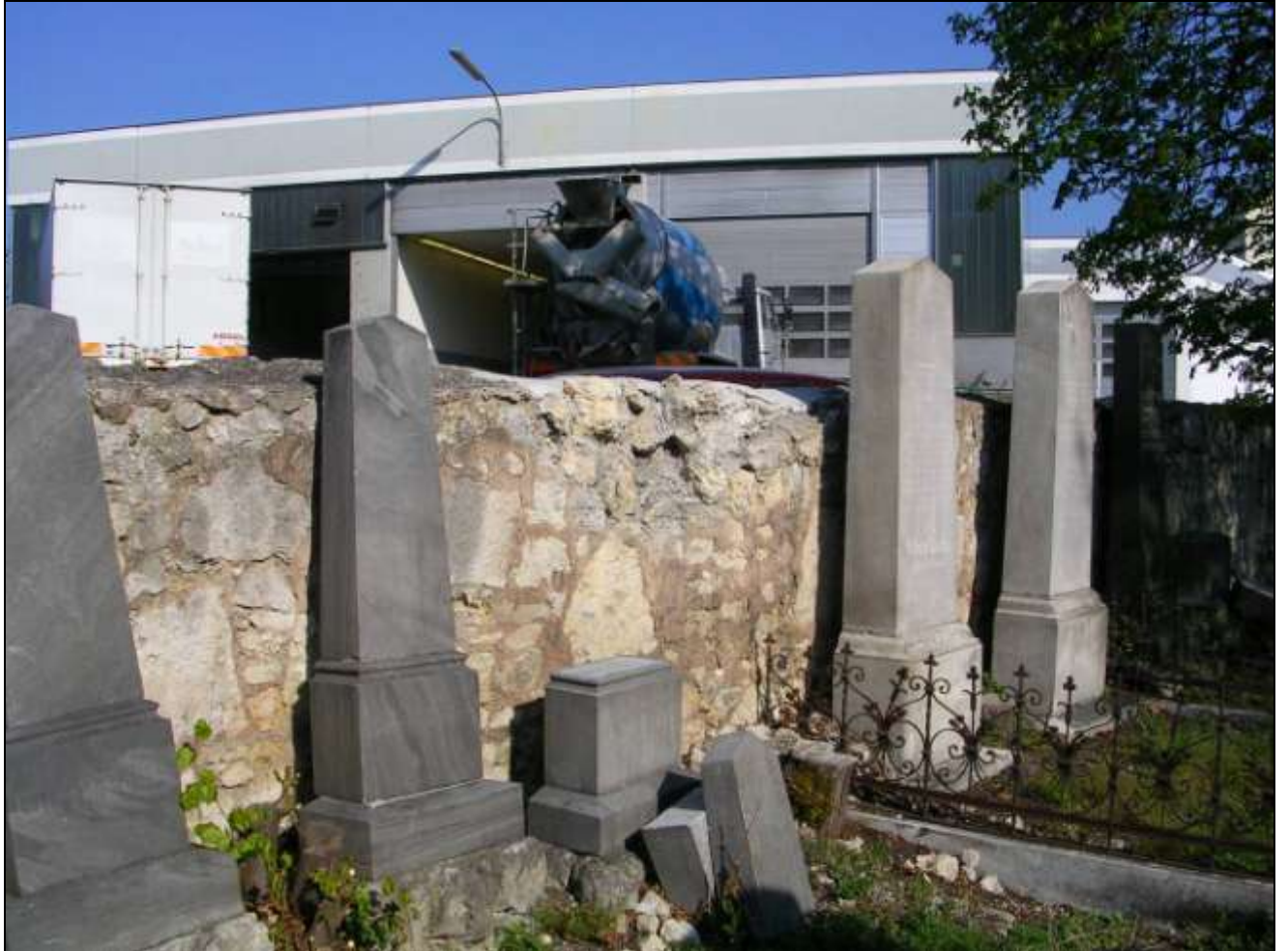
Bild 17: Westmauer (innen) misslungene Sanierung der Maueroberfläche
