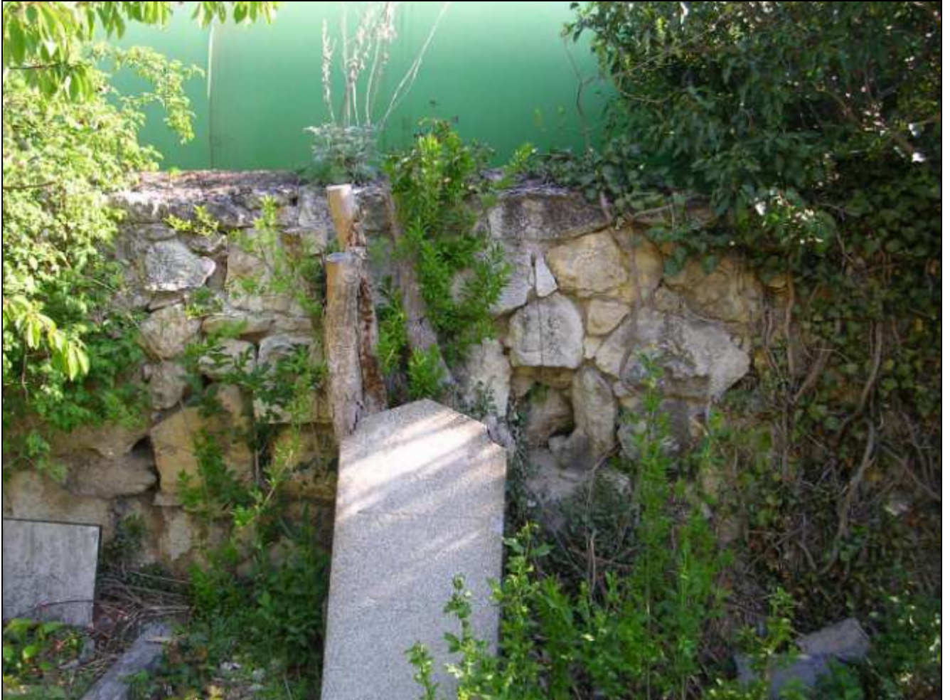
Bild 19: Nordmauer (innen): im krassen Gegensatz zur Außenseite in diesem Abschnitt starke Ausbrüche
