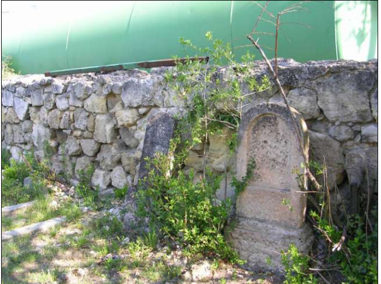
Bild 20: Nordmauer (innen): im krassen Gegensatz zur Außenseite in diesem Abschnitt (Mitte) starke Ausbrüche
