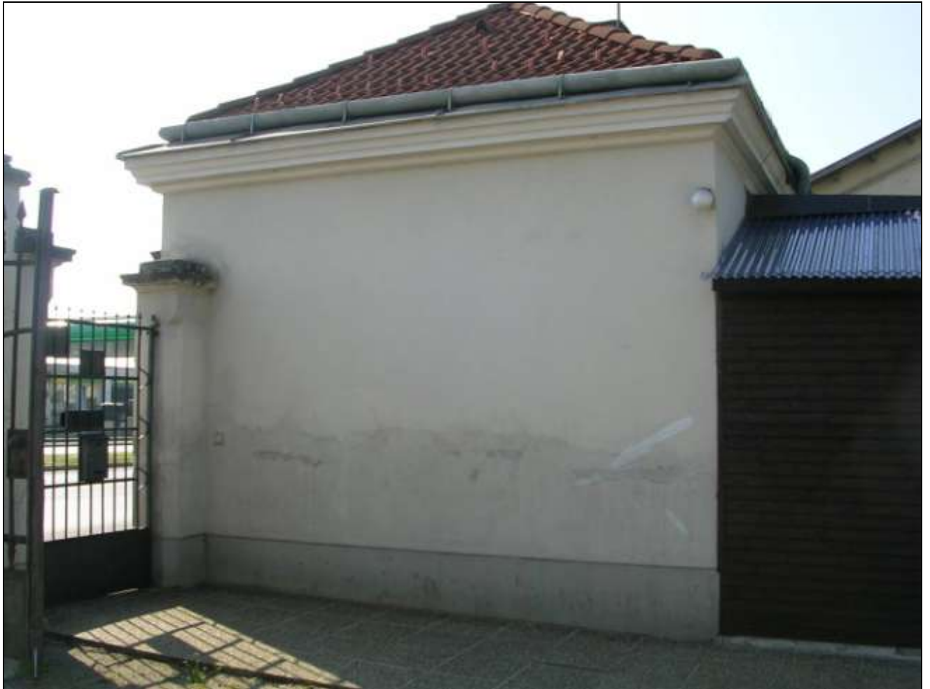
Bild 21: Gebäude (Nordseite „Gärtnerhaus“) Nässe- bzw. Feuchtigkeitsschäden
