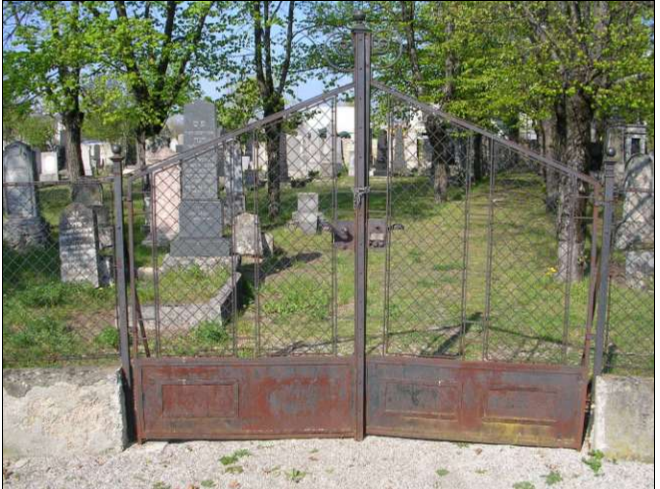
Bild 24: Zugangstor (innen) Rostschäden, kein funktionstüchtiger Schließ-/Sperrmechanismus
