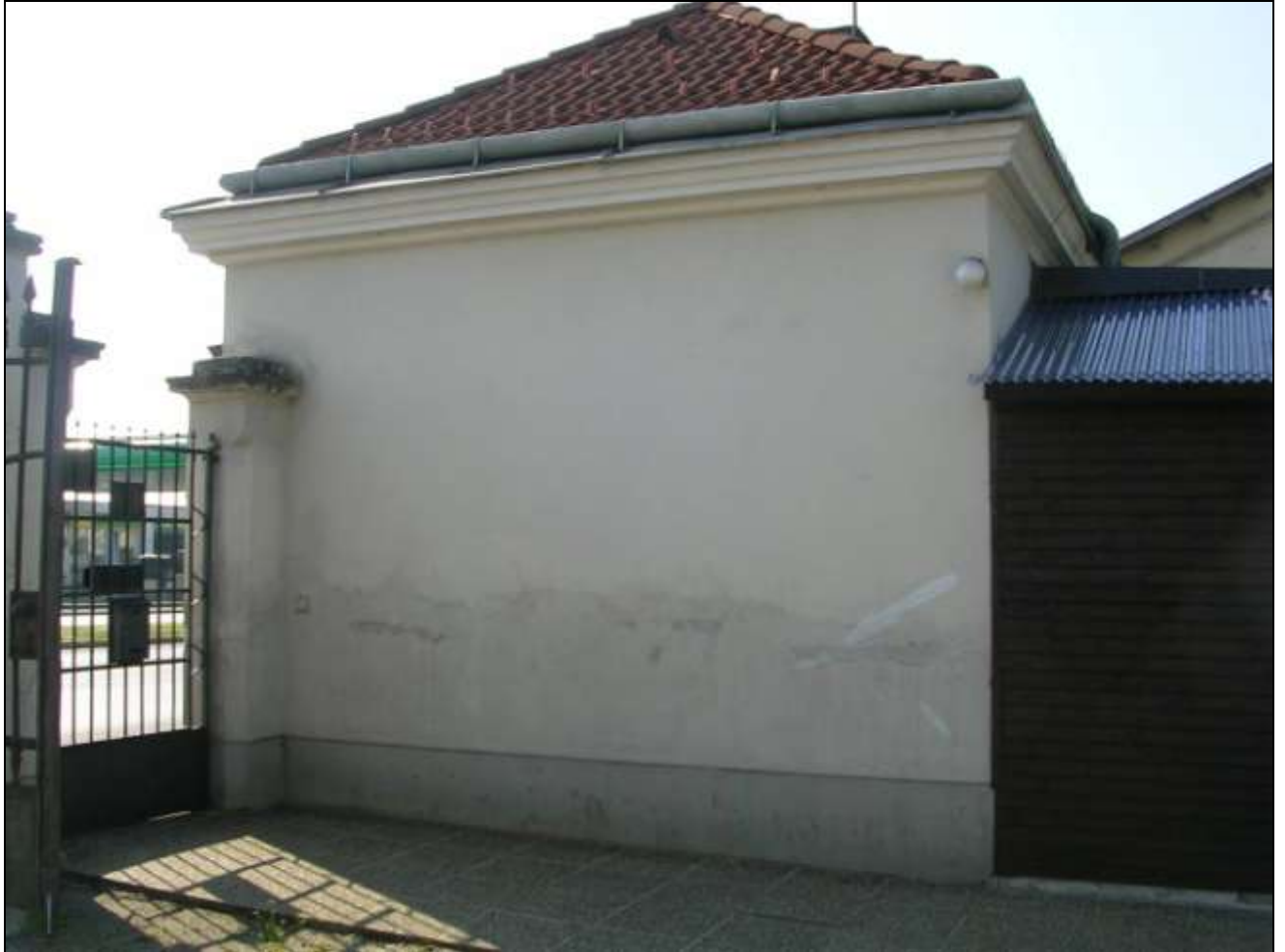
Bild 21: Gebäude (Nordseite „Gärtnerhaus“) Nässe- bzw. Feuchtigkeitsschäden
