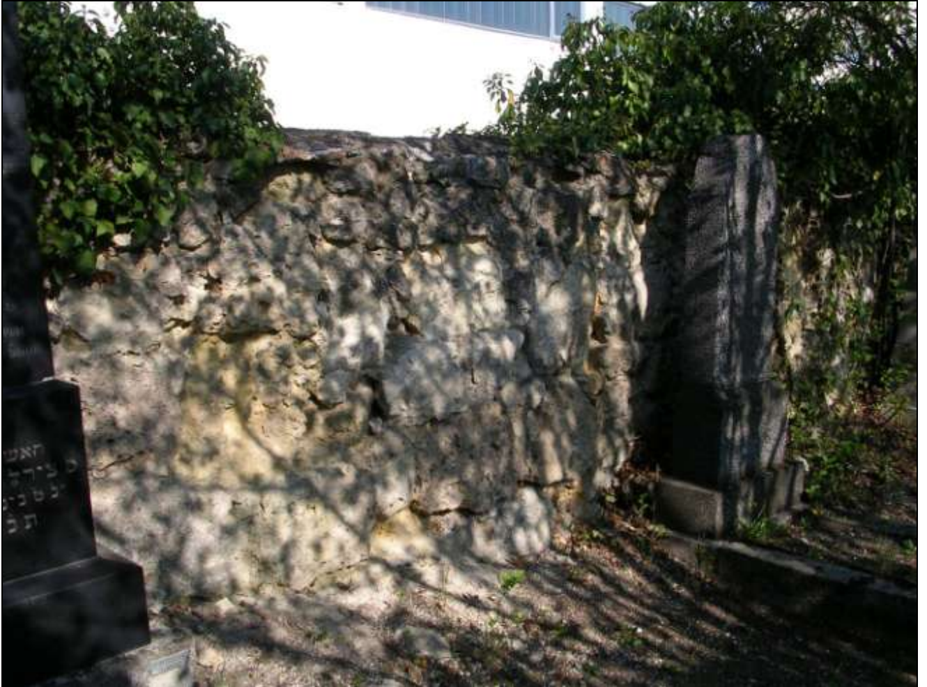
Bild 18: Westmauer (innen) Auswaschungen und Ausbrüche
