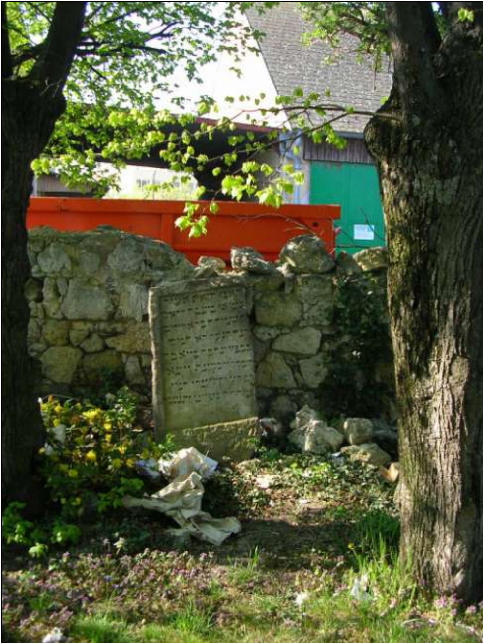
Bild 16: Südmauer (innen) zerfallener Mauerteil, Bruchsteine, Verschmutzung durch Müll
