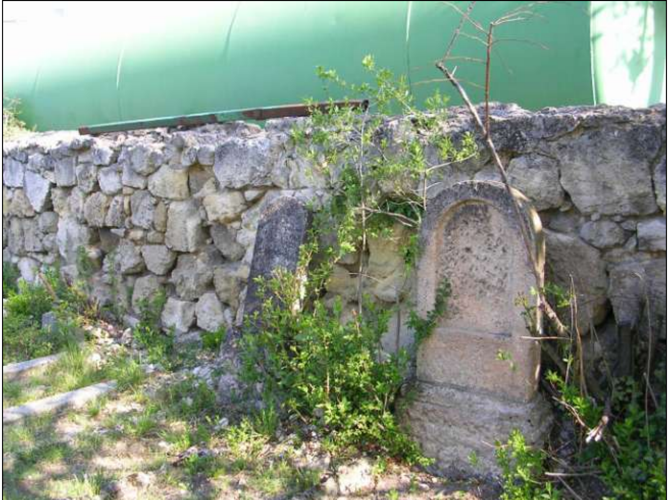
Bild 20: Nordmauer (innen): im krassen Gegensatz zur Außenseite in diesem Abschnitt (Mitte) starke Ausbrüche
