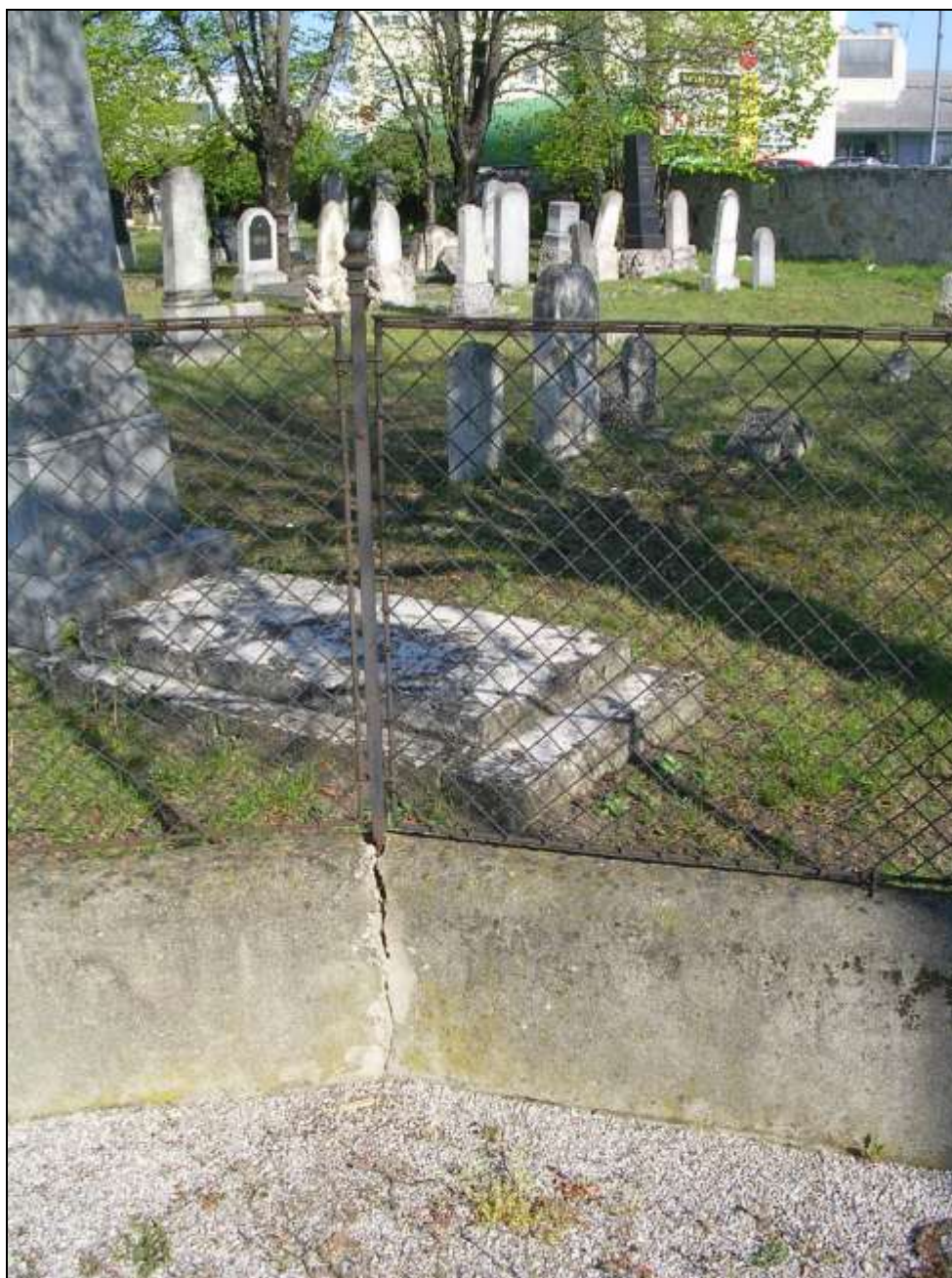
Bild 26: Mauersockel mehrere Risse im Beton
