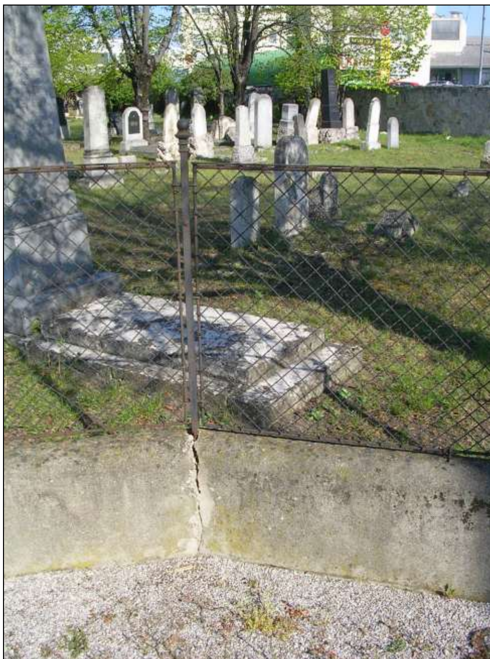
Bild 26: Mauersockel mehrere Risse im Beton
